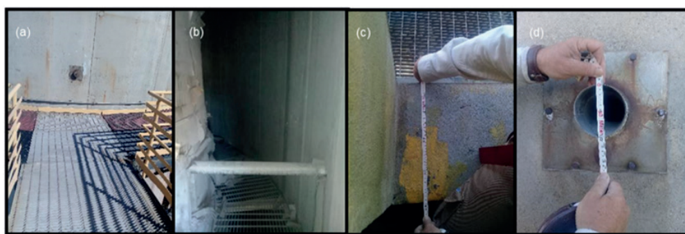
Figura 4. (a). Plataforma de acesso na altura de 63 m. (b). Vão interno da chaminé com plataforma interna de 1m de largura. (c). Confirmação da espessura da parede externa. (d). Verificação dos dutos instalados para amostragem isocinética.
