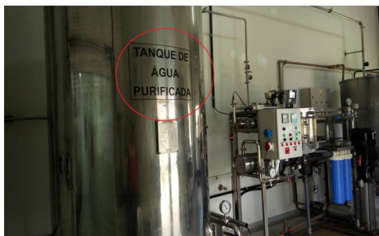
Figura 3. Tanque de Água Purificada. Fonte: autor (2017).
