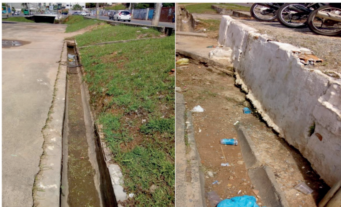
Figura 10 – Canais coletores de águas pluviais deteriorados
