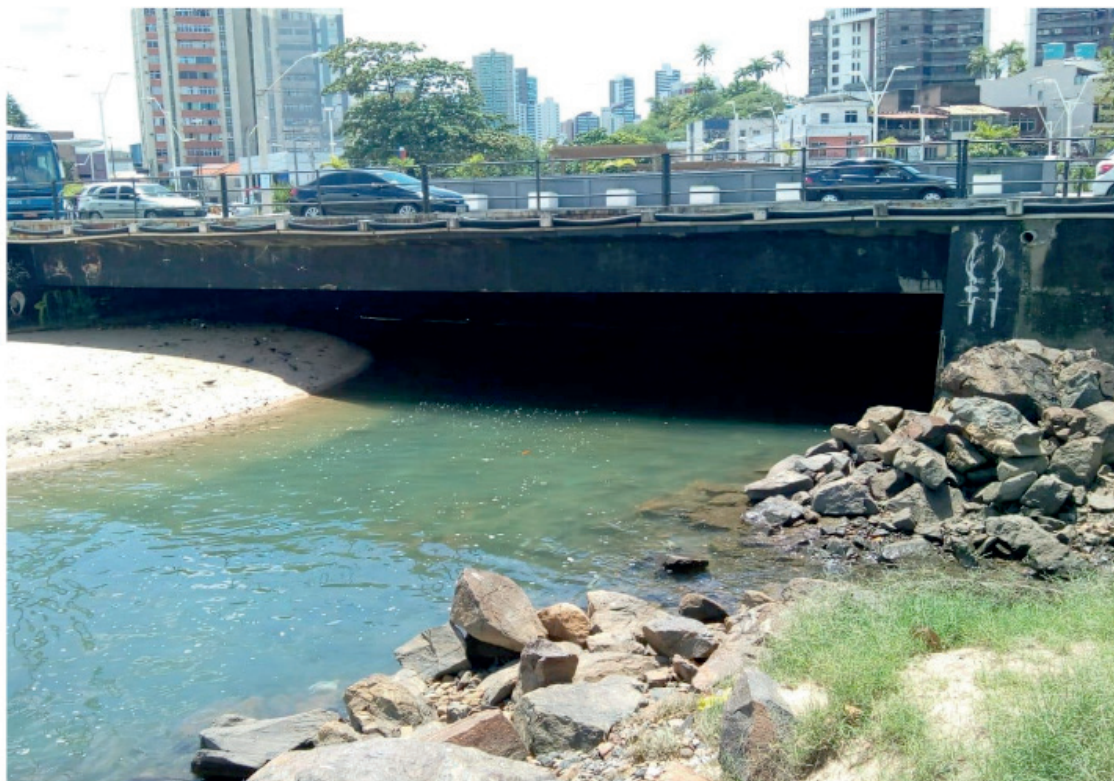
Figura 14 – Canal de deságua da macrodrenagem na praia do Rio Vermelho, Salvador.
