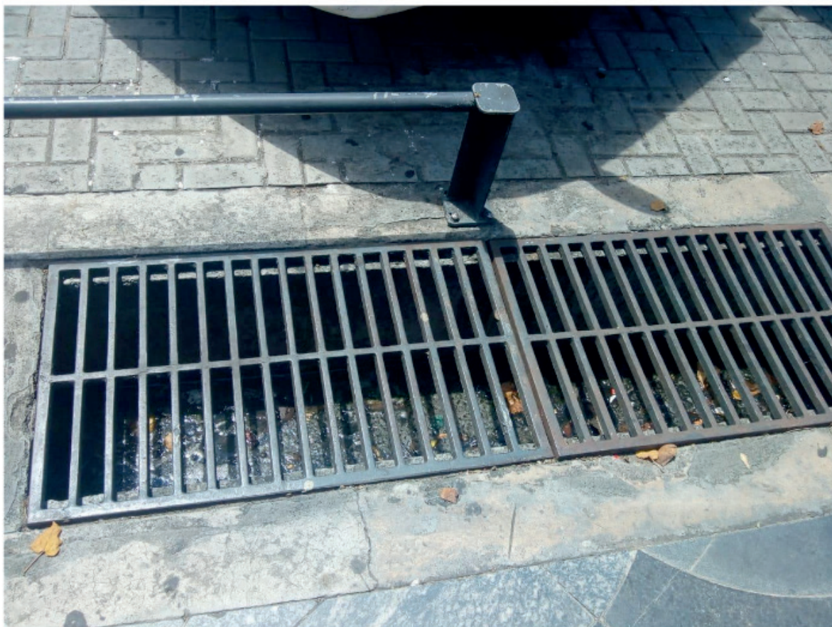
Figura 13 – Dispositivo de captação das águas pluviais no Largo da Mariquita
