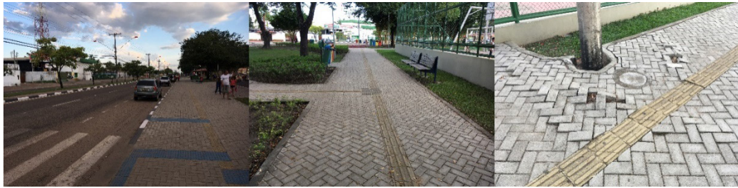
Figura 7 – Via de intenso fluxo, passeios largos, pisos táteis e patologias.
