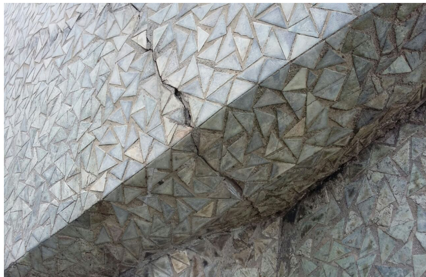
Figura 18: Detalhe do dano.
