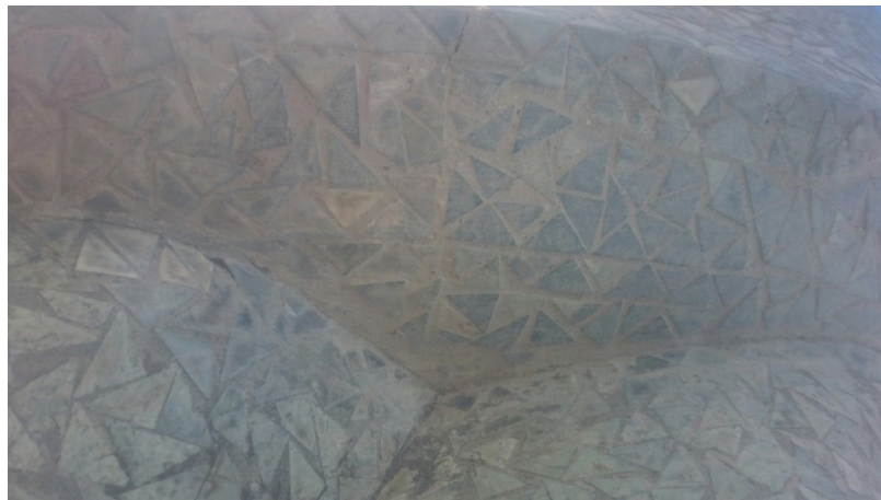
Figura 24: Trecho restaurado em junho de 2017.
