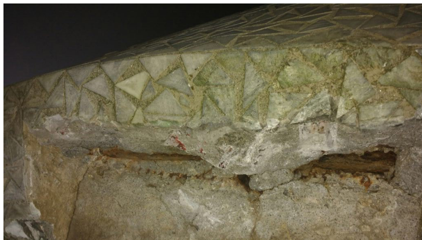
Figura 19: Detalhe do trecho após a retirada do material desprendido. Com ferragem a mostra.
