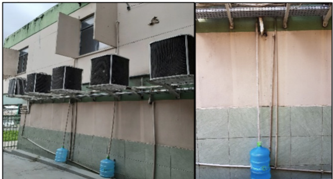
Figura 2 - Coleta de água dos aparelhos de ar condicionados
