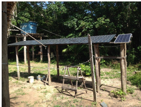
Figura 1- Gerador Fotovoltaico do Sistema de Anã
