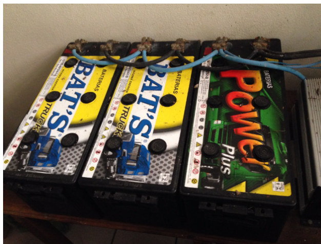
Figura 8 - Banco de baterias
