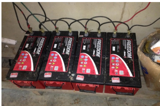
Figura 2 - Banco de baterias
