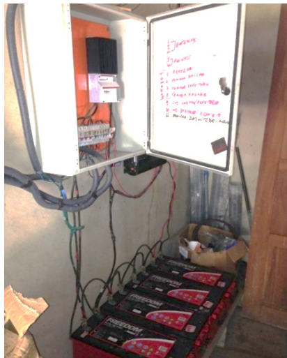
Figura 4 - Banco de baterias, controlador de carga e quadro de disjuntores do Sistema de Anã Fonte: Autoria Própria
