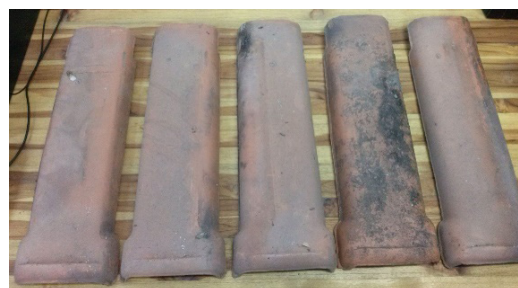
Figura 2 – Telhas cerâmicas degradadas
