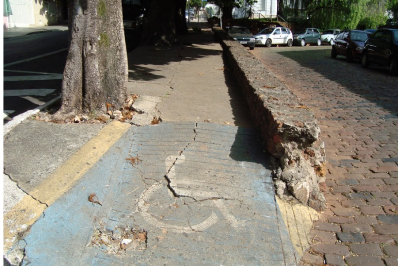
Figura 6 – rampa em desacordo com NBR 9050
