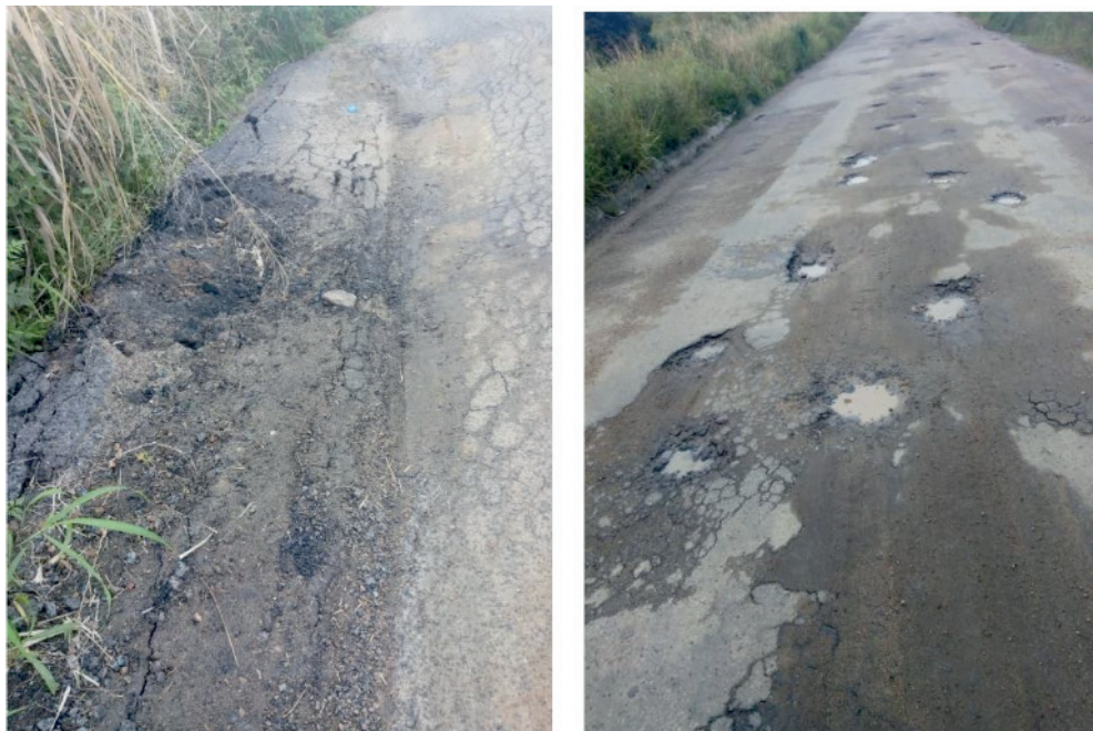
Figura 2 – Seções de alto estado de degradação nos Trechos analisados
