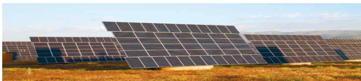
Figura 2 - Painéis solares fotovoltaicos
