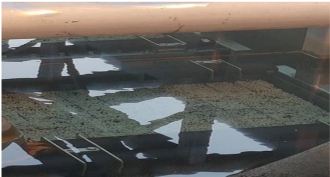
Fotografia 2- Skid com membranas submersas em água decantada
