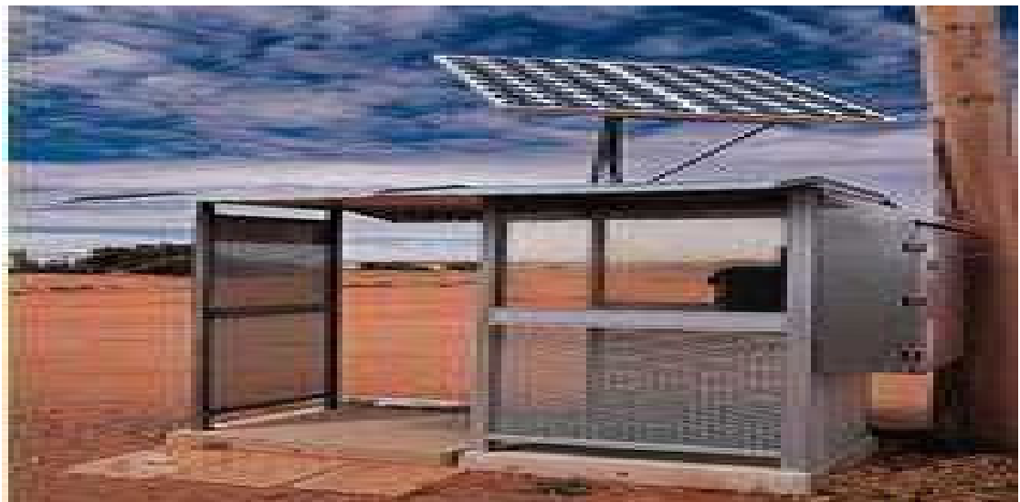
Figura 1 - Painel solar fotovoltaico que usa energia da luz solar para sustentar telefone celular público em local isolado na Austrália
