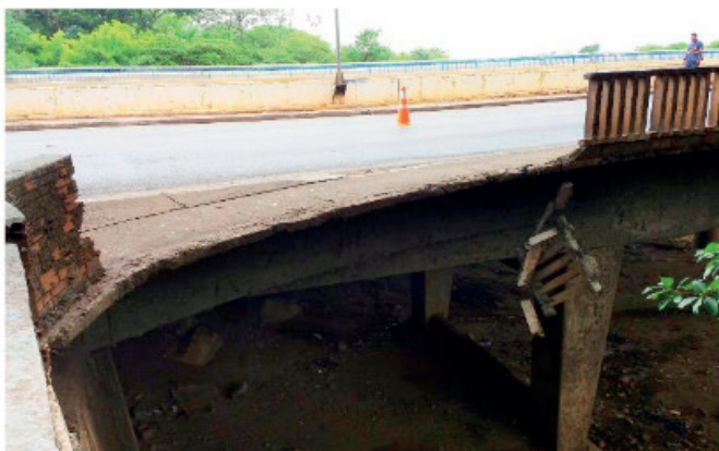
Figura 12. Parte do passeio sem guarda-corpo
