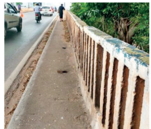
Figura 13. Passeio não adequado à norma
