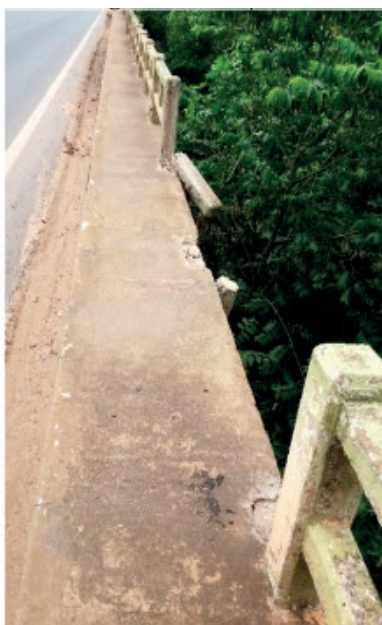
Figura 10. Avarias e inexistência de guarda-corpo
