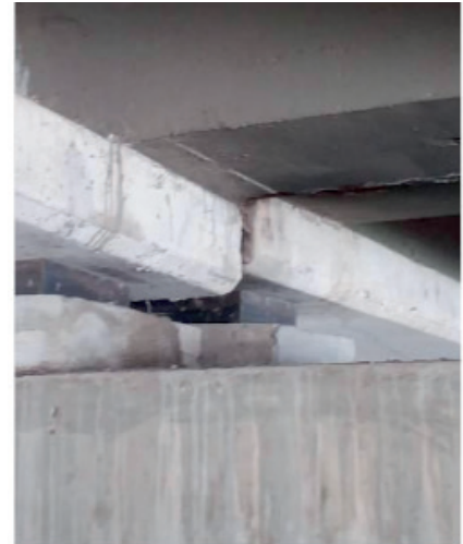
Figura 5. Deslocamento entre vigas de apoio
