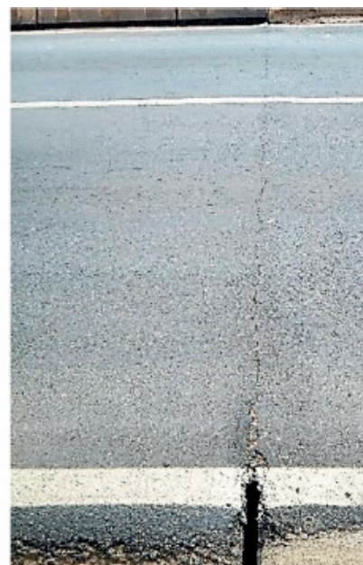
Figura 11. Fissuras sobre junta de dilatação
