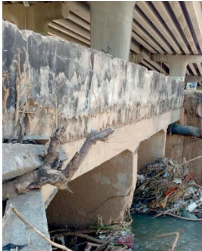
Figura 4. Deterioração do canal sob o viaduto
