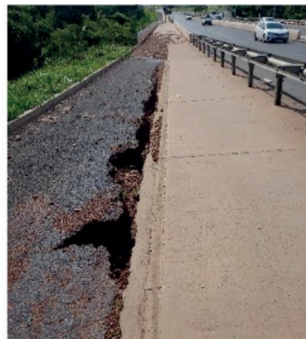
Figura 9. Fissura no acesso de pedestres à ponte
