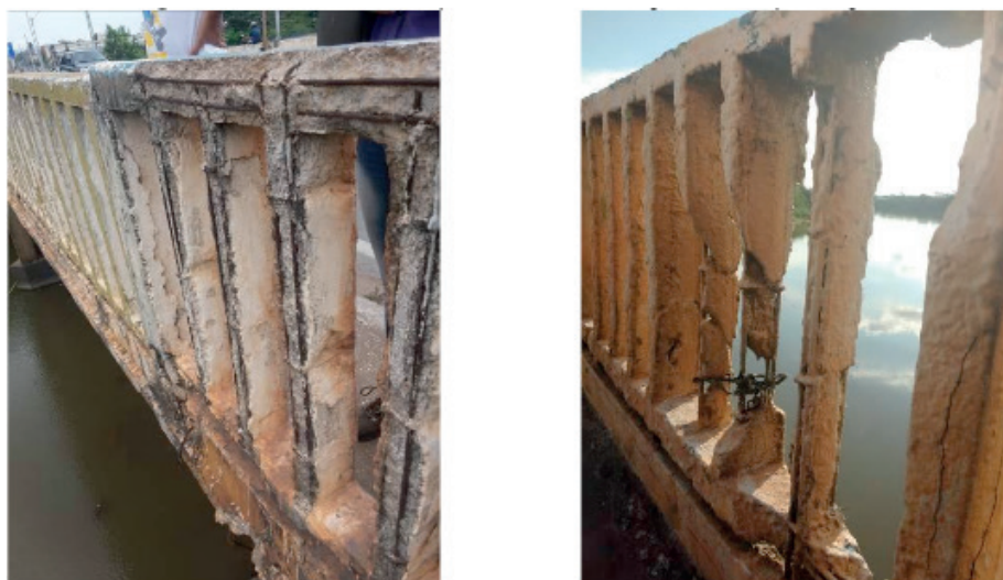
Figura 15. Guarda corpo com a armação sem proteção
