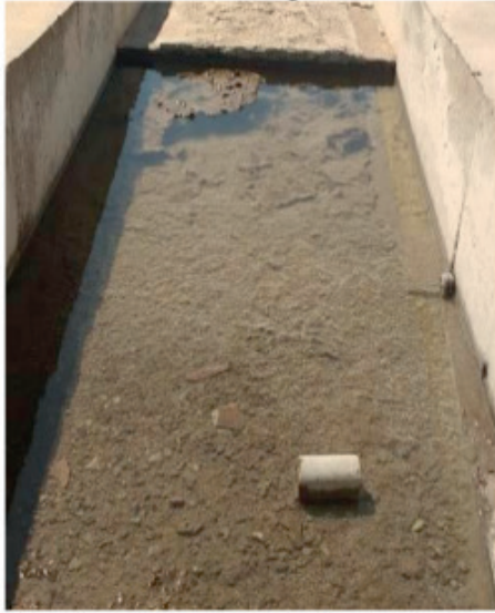
Figura 2. Acúmulo de água sobre tabuleiro
