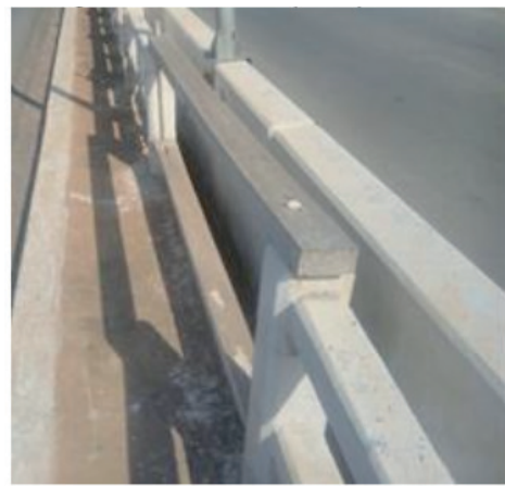
Figura 7. Guarda corpo improvisado
