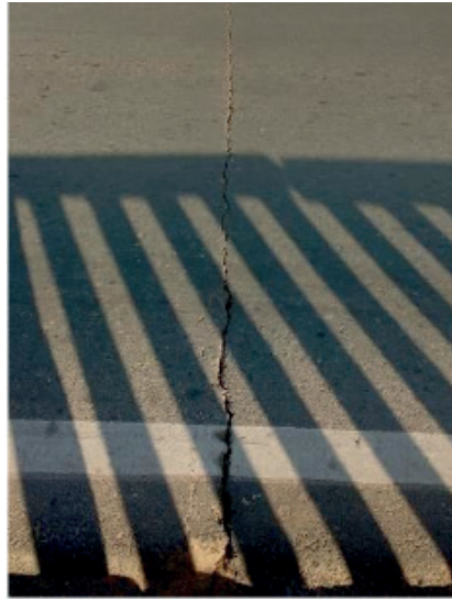
Figura 16. Trinca ocasionada pelo recapeamento da junta de dilatação
