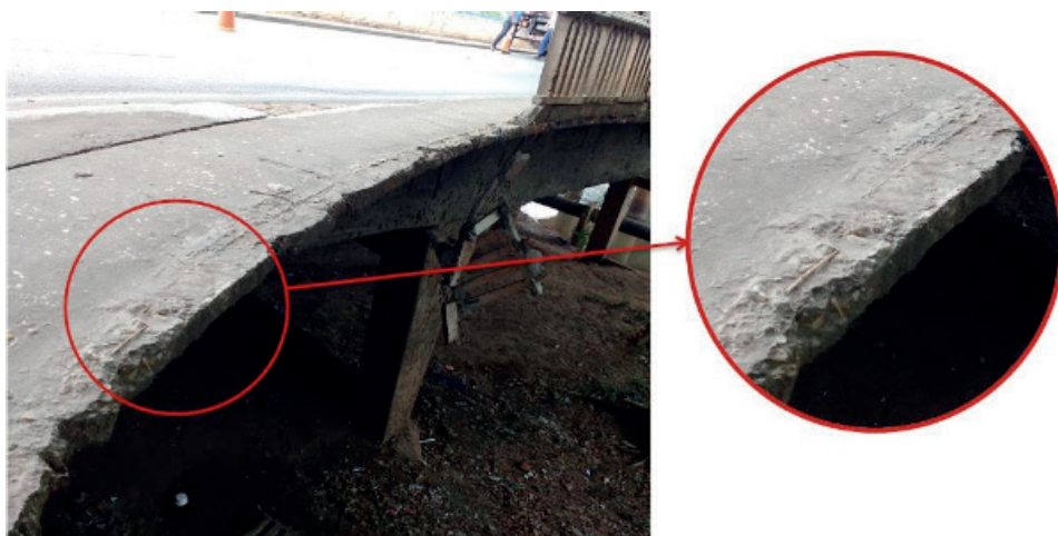
Figura 14. Exposição das armaduras no passeio
