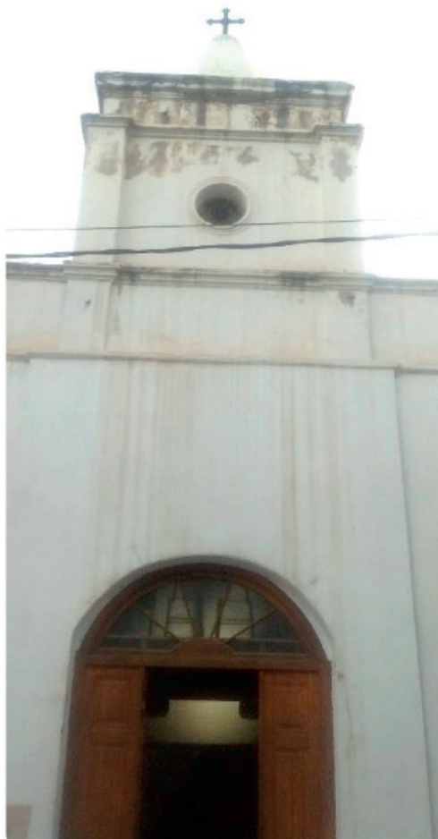
Fig. 5: Deterioros en la fachada Norte de la Iglesia Parroquial Ntra. Sra. del Carmen. (Fuente: propia, 2019)
