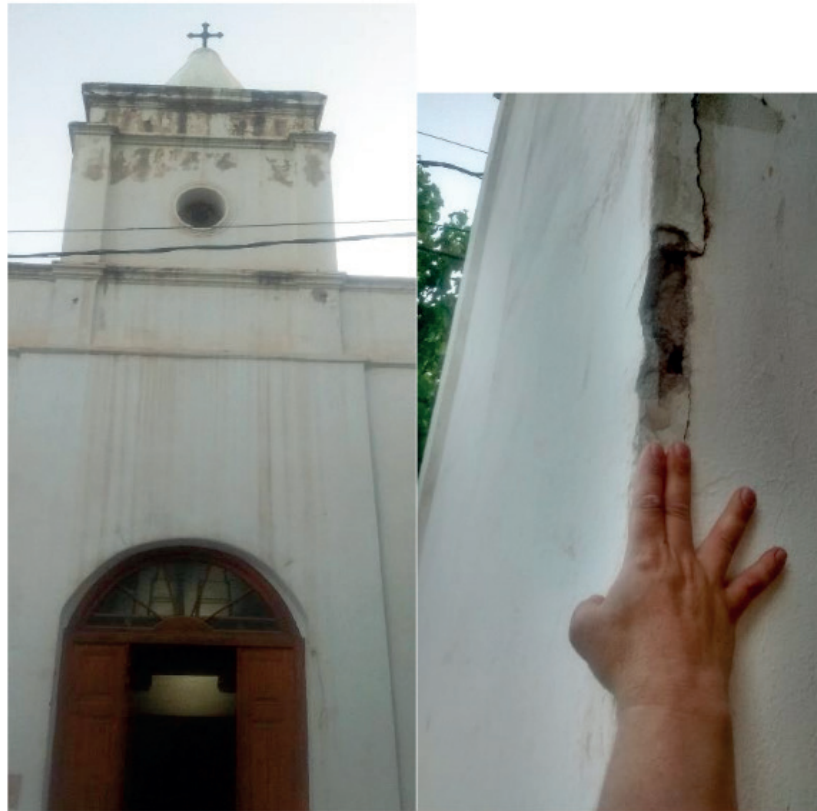
Fig. 9: Frente Norte de la Iglesia con deterioros por causa de la lluvia y fisuras del muro. (Fuente: Propia)
