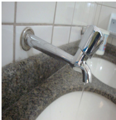
Figura 6 – Exemplo de torneira com falta de estanqueidade no elemento de vedação
