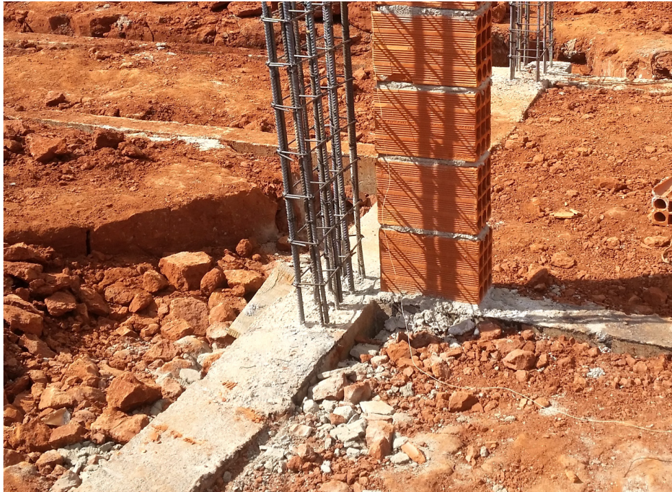
Figura 9 - Diferença de espessura entre vigas baldrame e pilar
