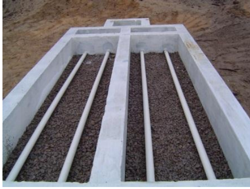
Figura 1: Biofiltos Submersos na época da construção
