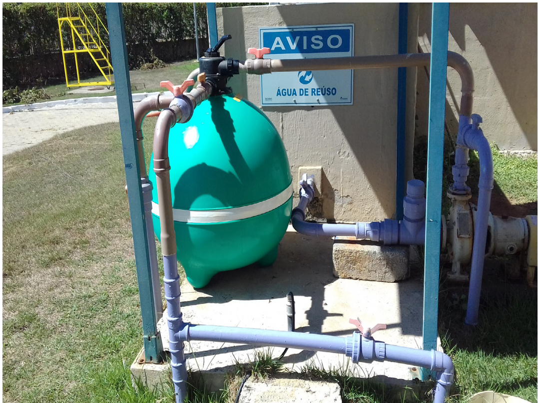
Figura 6. Filtro de areia instalado na ETE Centro.
