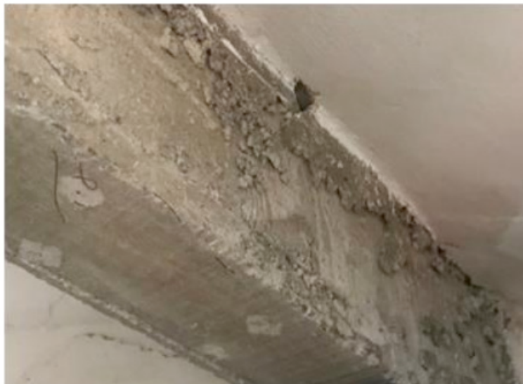
Figura 6 – Viga da sala de ensaios com concreto segregado aderido à face.
