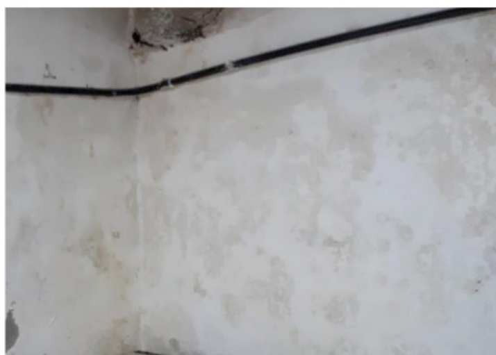
Figura 5 – Descascamento da pintura em paredes internas.
