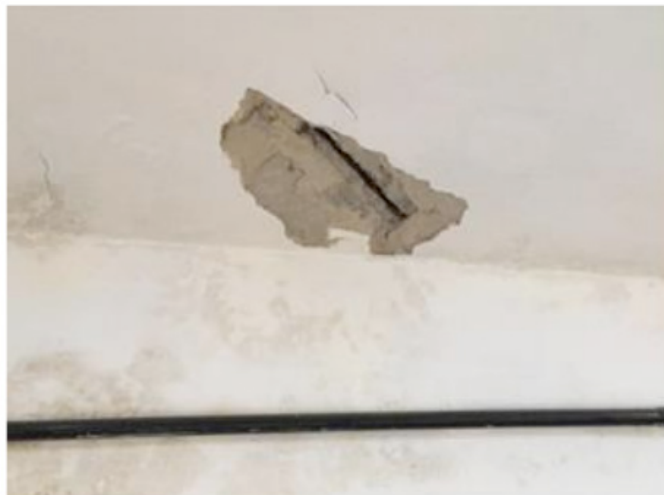
Figura 3 – Laje da sala de ensaios com armadura exposta e deslocamento de concreto.
