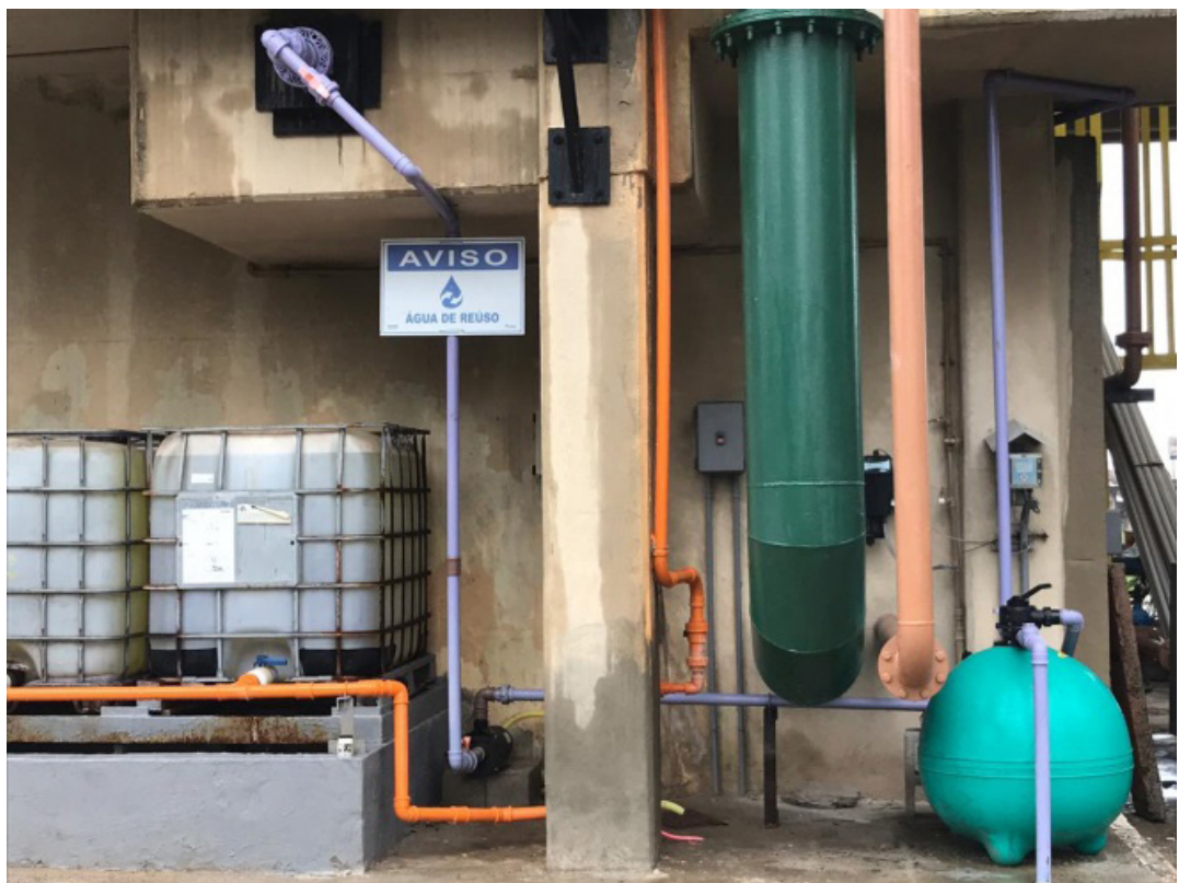
Figura 5. Filtro de areia instalado na ETE Aeroporto.
