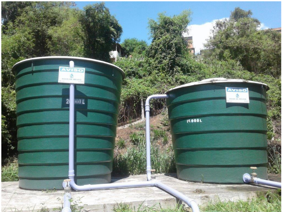
Figura 4. Reservatórios ETE Bandeirantes - capacidade total de 35 m 3 .
