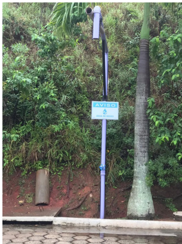
Figura 7. Tomada para abastecimento de caminhões na ETE Aeroporto.
