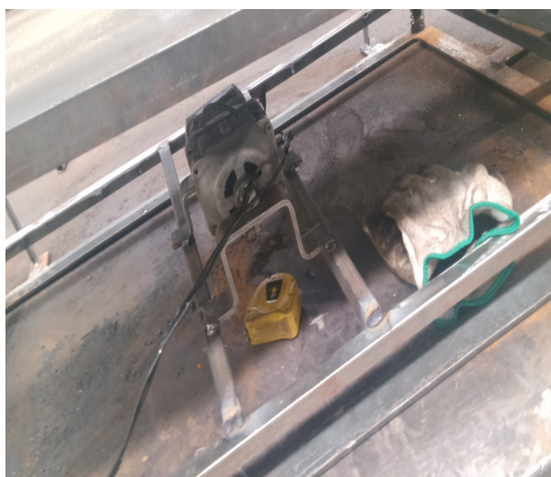
Figura 6: Motor e Chapas de Contrapeso.
