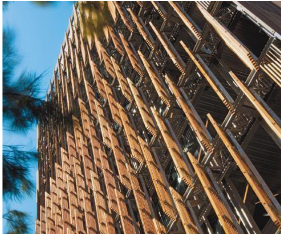
Figura 8: Os painéis de controle solar na fachada oeste do edifício.
