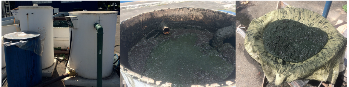
Figura 3. Sistema de coagulação-floculação da ETE Piloto
