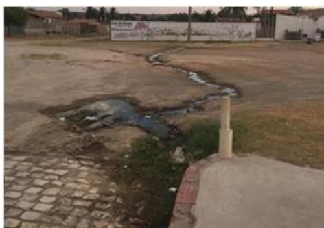
Figura 3 – Área com esgoto a céu aberto em ruas não calçada no bairro Leandro Bezerra
