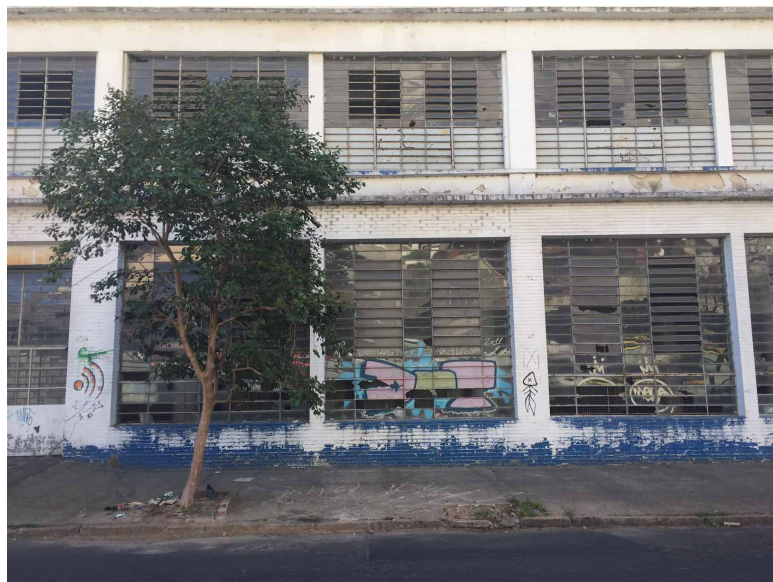
Figura 10: Prédio com as janelas quebradas na mesma rua do complexo Vila Flores.
