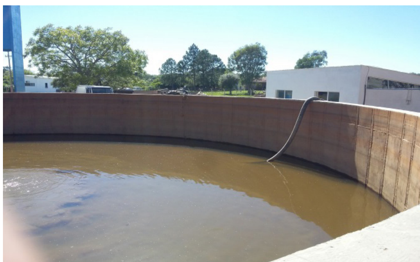
Figura 1 – Tanque de equalização do lodo.
