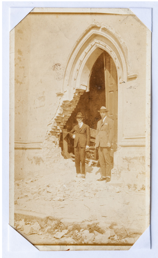
Figura 2 – Dano causado por bombardeio
