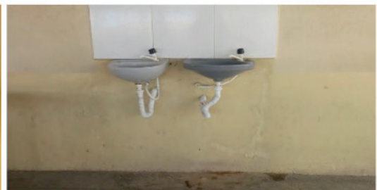
Foto 12 – Refeitório. Ocorrência de bolor e infiltração.
