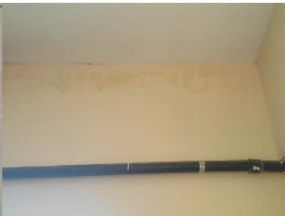
Foto 20 – Sala 1. Presença de eflorescência.
