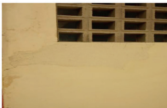
Foto 02 – Parede do banheiro masculino e feminino. Lado direito. Ocorrência: fissura.
