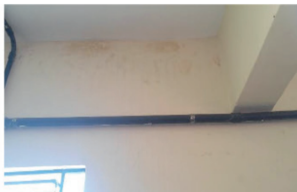
Foto 22 – Sala 3. Presença de eflorescência.
