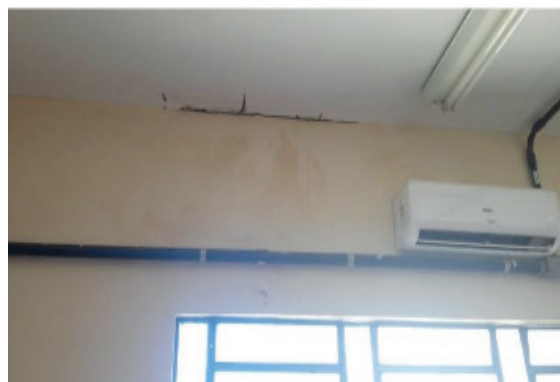
Foto 23 – Sala 1. Presença de eflorescência e fissura.
