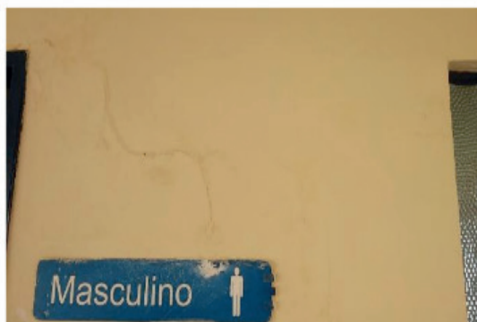
Foto 01 – Parede do banheiro masculino e feminino. Lado esquerdo. Ocorrência: fissura e eflorescência.
