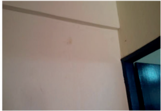
Foto 16 – Banheiro Masculino. Presença de eflorescência.
