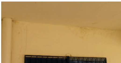
Foto 11 – Refeitório. Ocorrência de bolor, eflorescência e infiltração.
