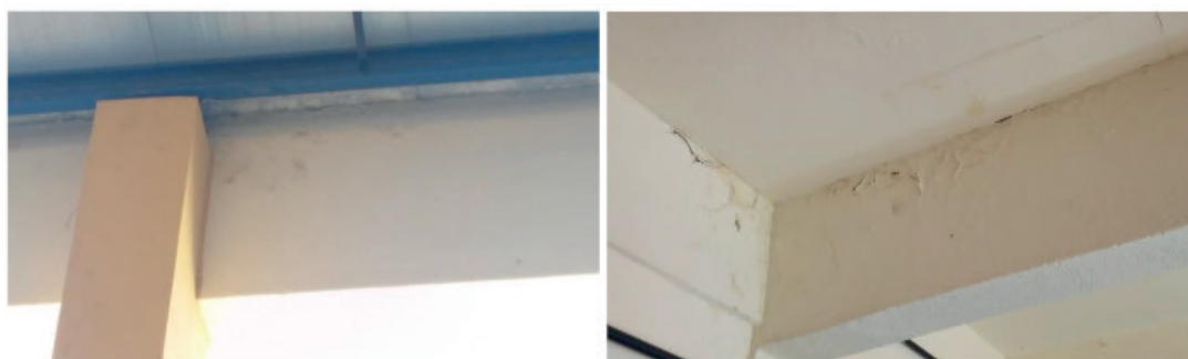
Foto 27 – Parte da Frente Externa. Presença de bolor.
