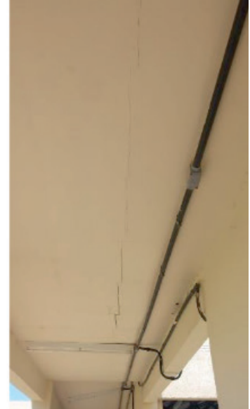
Foto 10 – Refeitório. Fissuras no teto.
