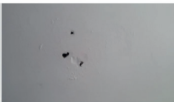
Foto 04 – Banheiro feminino. Ocorrência: bolor no teto e infiltração.
