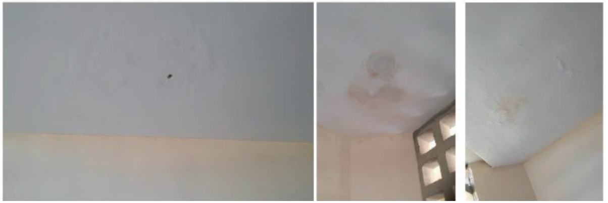
Foto 05 – Banheiro Masculino. Ocorrência: bolor, eflorescência e infiltrações.
