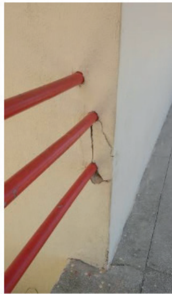
Foto 09 – Refeitório. Fissuras na parede.
