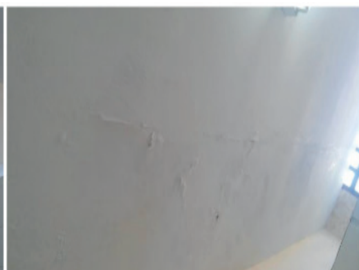
Foto 14 – Banheiro Feminino. Presença de bolor e fissuras.
