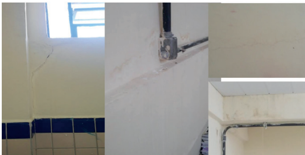
Foto 28 – Biblioteca. Presença de Fissuras, eflorescência e bolor.
