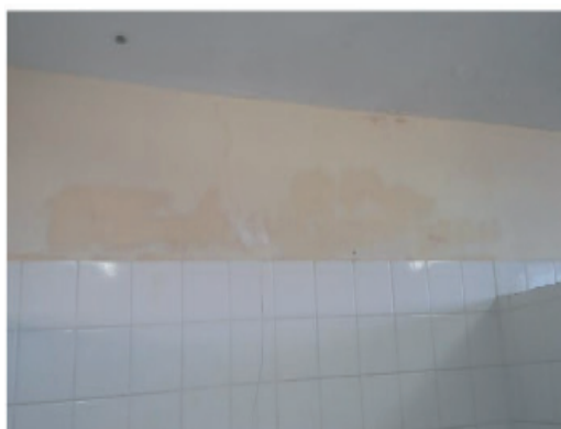
Foto 13 – Banheiro Feminino. Presença de eflorescência e infiltração.
