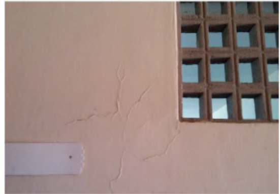
Foto 18 – Banheiro Masculino. Presença de bolor e fissura.
