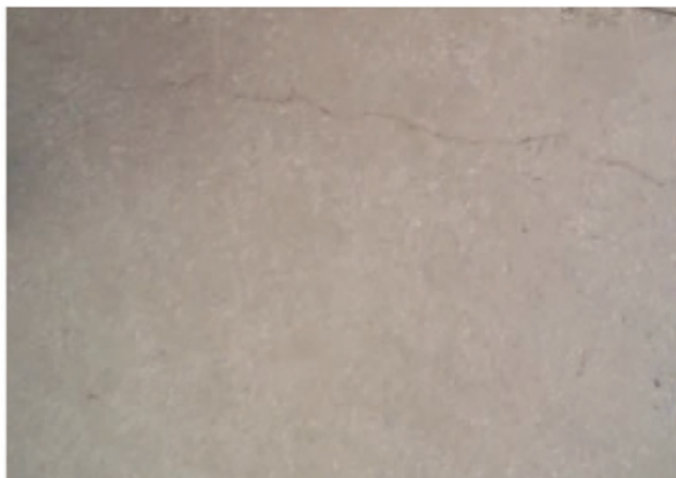
Foto 19 – Sala 1. Presença de Fissura no chão.
