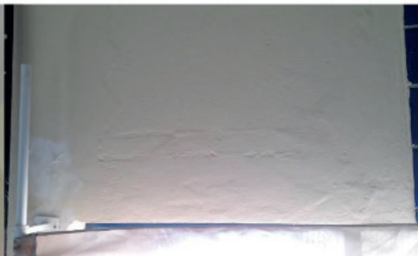
Foto 26 – Sala 4. Presença de eflorescência.
