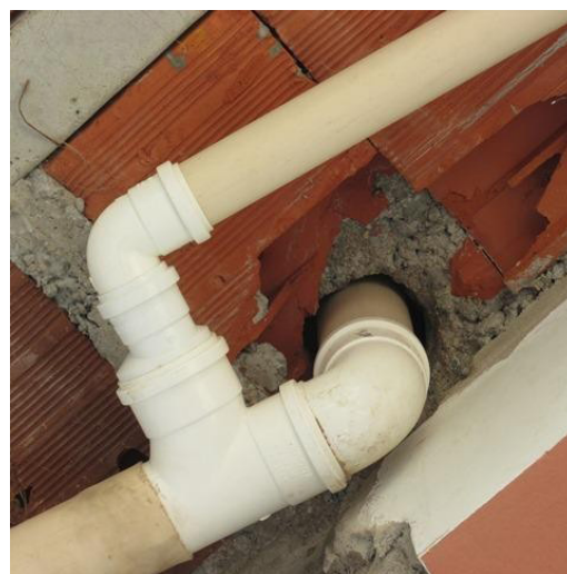
Figura 3-b: Furo na laje
