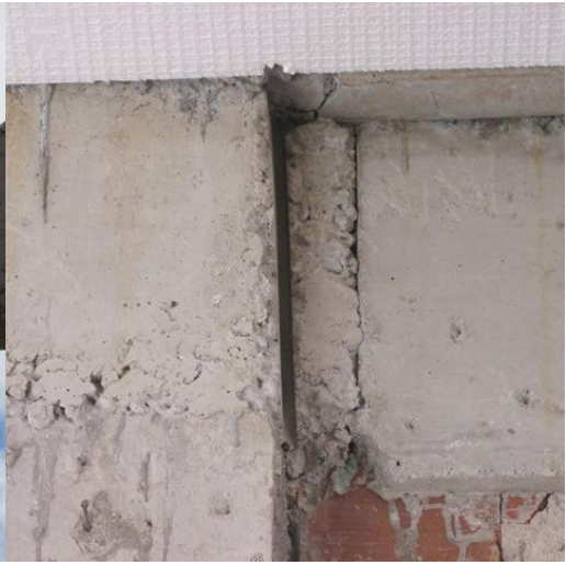
Figura 8-b: Junta de concreto mal executada
