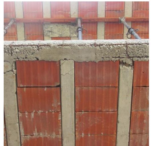
Figura 4-b: Armadura exposta emlaje
