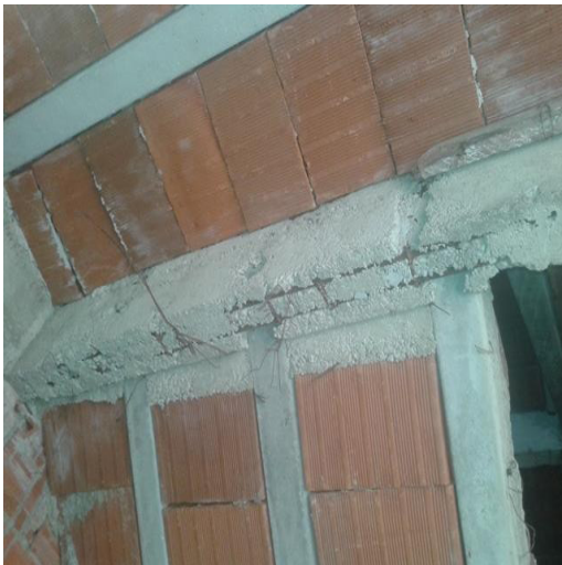
Figura 9-a: Viga sem cobrimento
