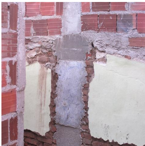
Figura 5-a: Pilar mal executado
