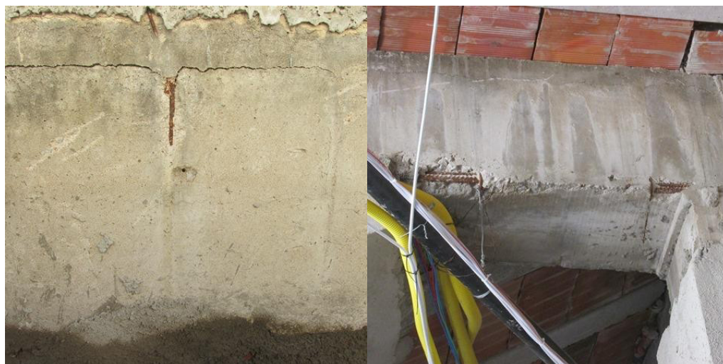
Figura 7-a: Corrosão de armaduras em laje viga
