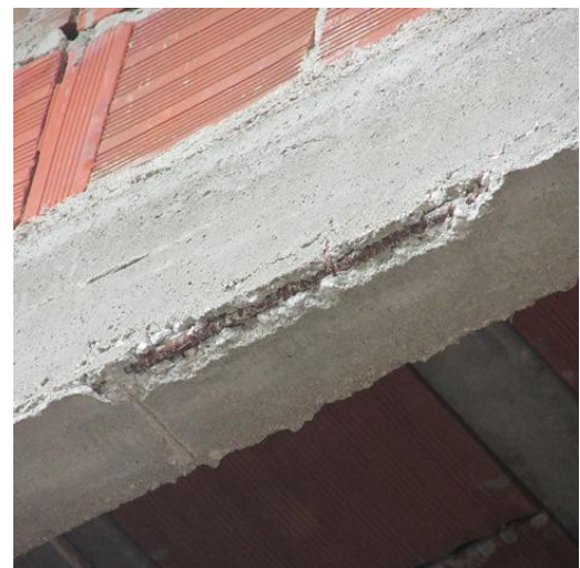
Figura 5-b: Armadura exposta em viga
