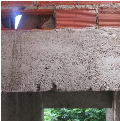
Figura 4-a: Armadura aparente em viga
