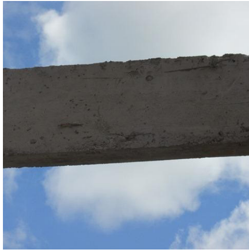
Figura 8-a: Viga mal adensada
