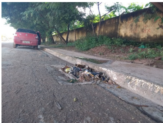
Figura 4: Av. Castelo Branco com boca de lobo obstruída pelo lixo.
