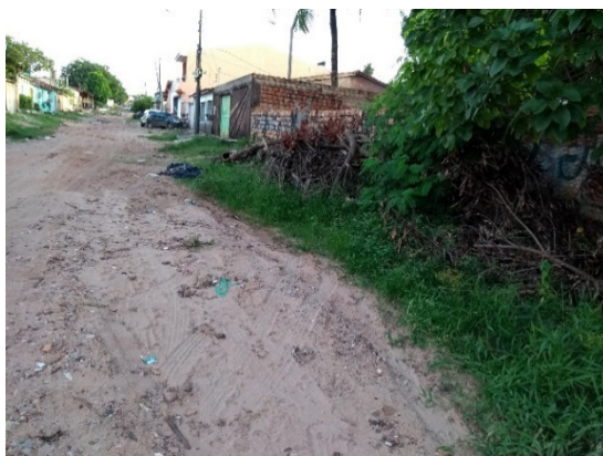
Figura 6a: Rua Nova Olinda sem pavimentação.
