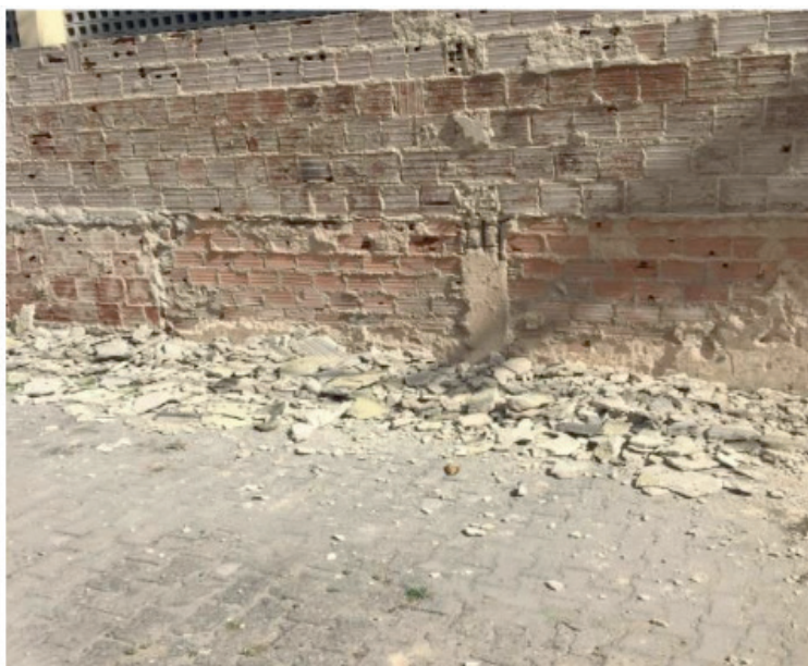
Figura 7 – Análise visual da estrutura corrompida.
