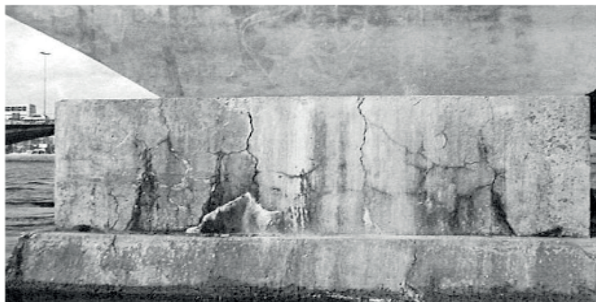
Figura 3 – Bloco de fundação com intensa fissuração e lixiviação induzida por RAA.
