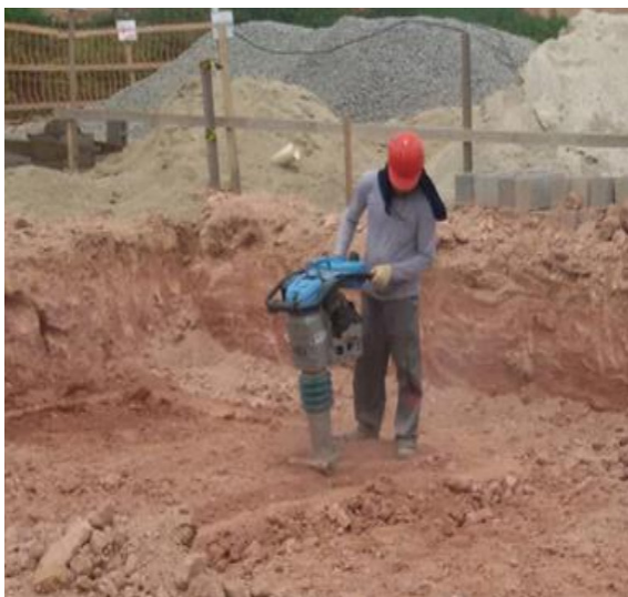
Figura 7 – Compactação do solo.
