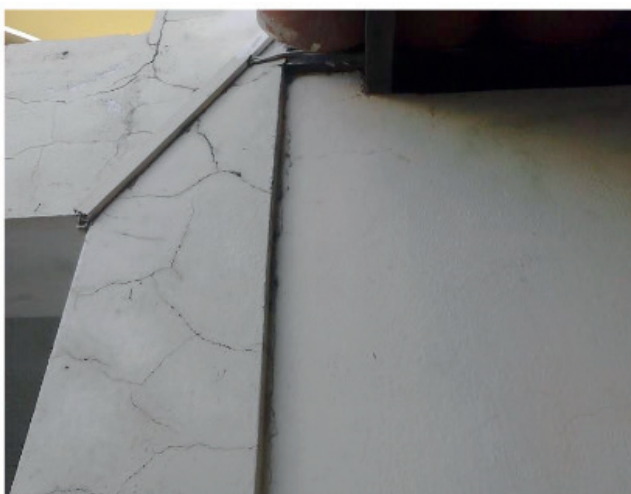
Figura 8 – Fissuras no revestimento de pilar e viga da caixa d'água.
