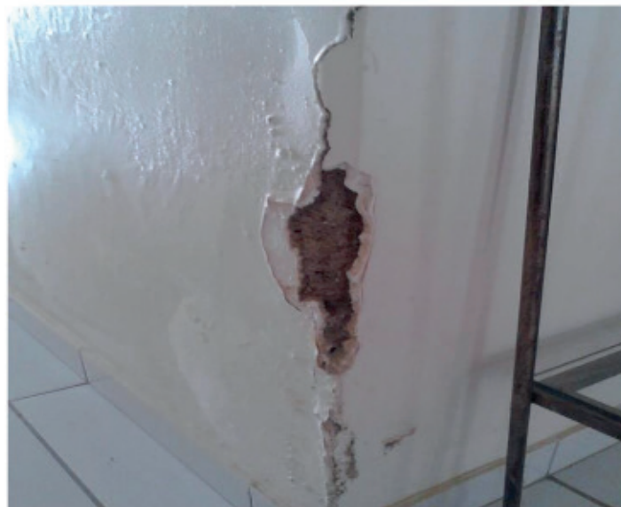
Figura 6 – Revestimento de pilar deteriorado.
