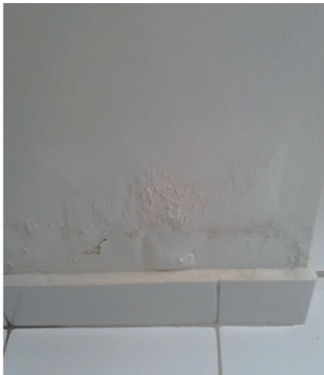
Figura 10 – Formação de bolhas no reboco próxima ao rodapé.
