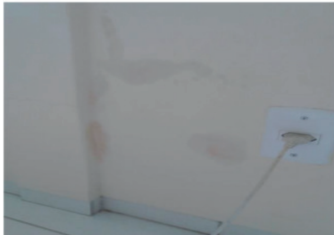
Figura 5 – Mancha de umidade no encontro com a parede de alvenaria 8 furos e no pilar.
