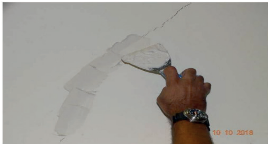
Figura 12 –Trinca em alvenaria da edificação.
