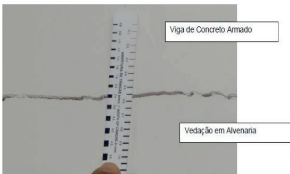
Figura 09 –Rachadura na parede externa da sala do cofre.
