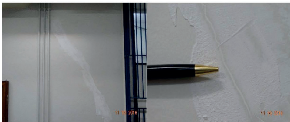
Figura 17 – Monitoramento da rachadura na alvenaria interna no canto esquerdo da sala do cofre, aparentemente não ativa.
