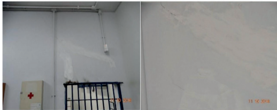
Figura 15 – Monitoramento da rachadura na alvenaria externa acima da porta de acesso do cofre, aparentemente não ativa.
