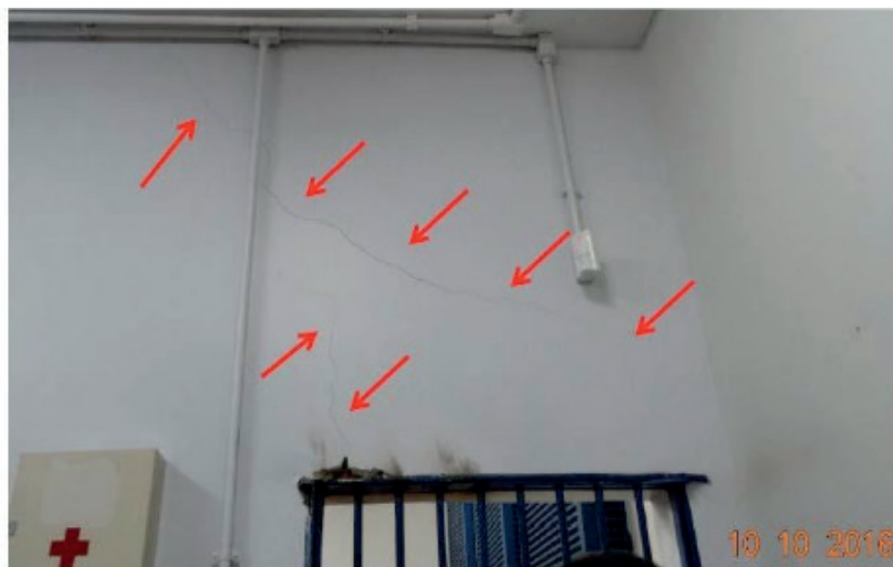
Figura 10 – Alvenaria externa acima da porta de segurança da sala do cofre.
