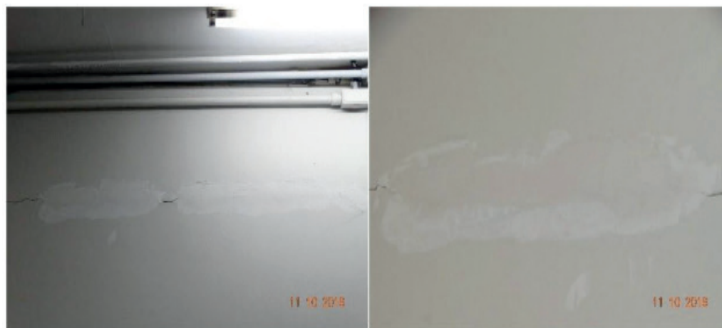
Figura 13 – Monitoramento da rachadura na parede externa do cofre, aparentemente não ativa.
