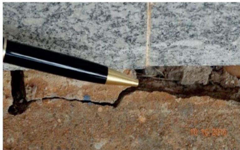
Figura 21 –Abertura entre piso e parede.
