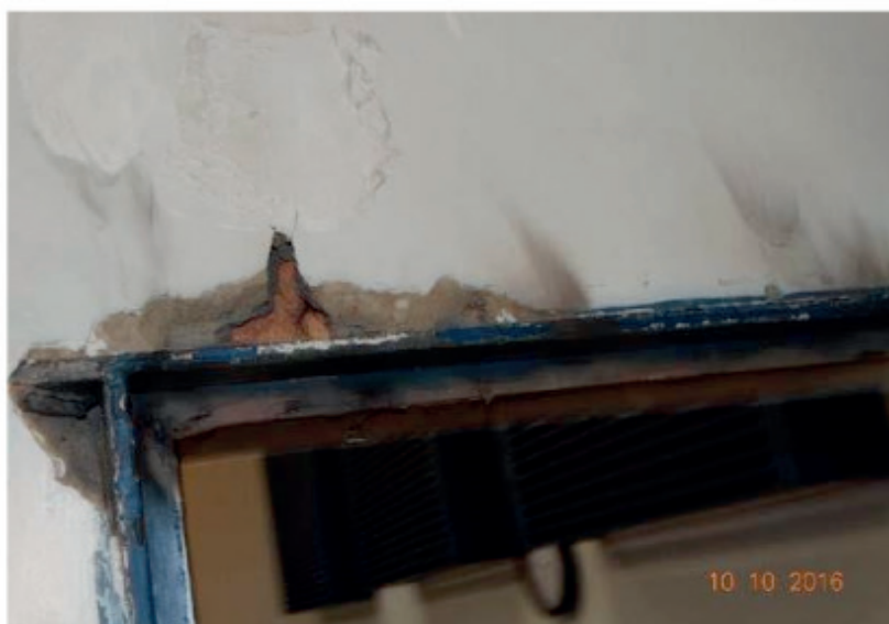
Figura 11 – Porta de entrada ao cofre sem verga.
