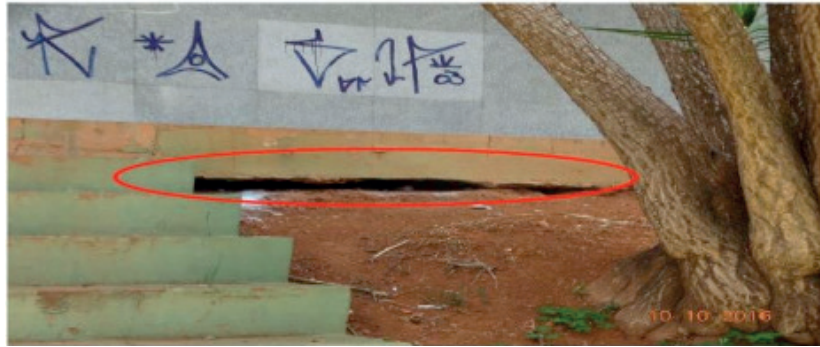
Figura 20 –Falha na parte interior da calçada externa na fachada norte.
