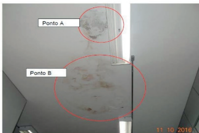
Figura 07 –Ponto de infiltração na laje de cobertura docorredor do Detran.
