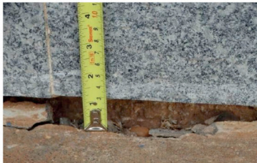
Figura 22 –Abertura de 3 (três) cm entre piso e parede.
