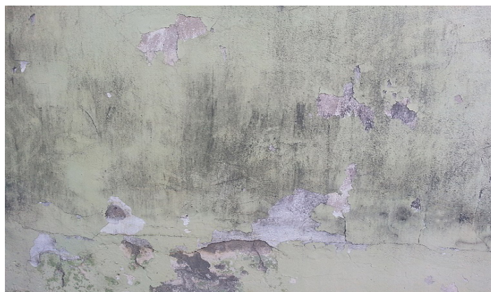
Figura 9 – Descascamento da pintura
