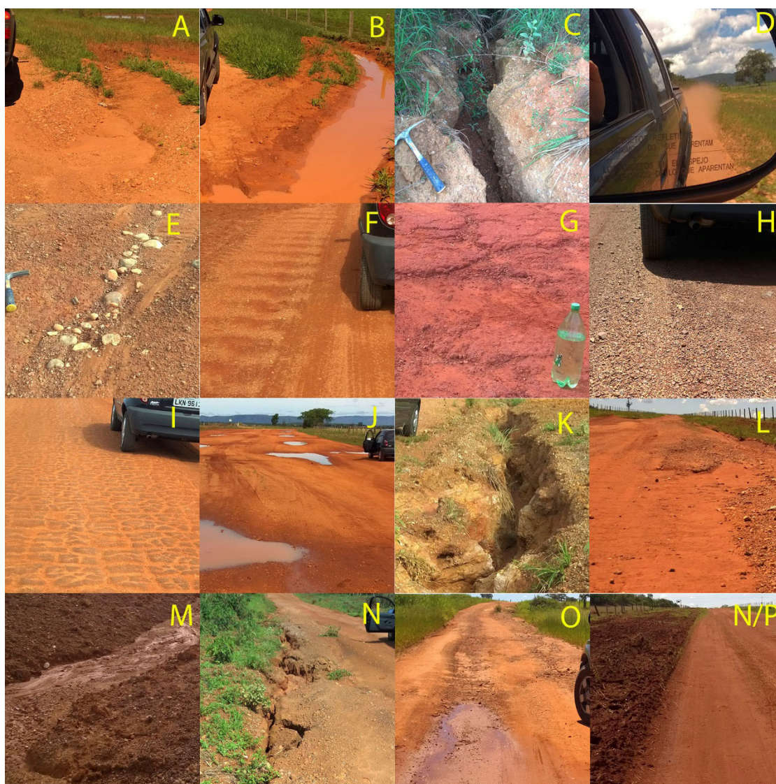
Figura 2: Manifestações patológicas e inadequações na MT-336
