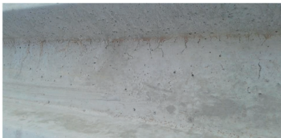
Figura 4 – Fissuras/ Fonte: Autor
