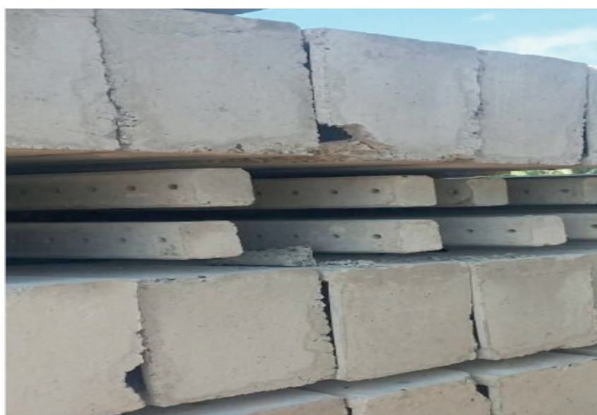
Figura 7 – Peças Quebradas a choques que sofrem no transporte. / Fonte: Autor
