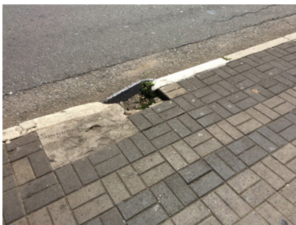
Figura 3 – Buraco na calçada Rua Augusta – 2016
