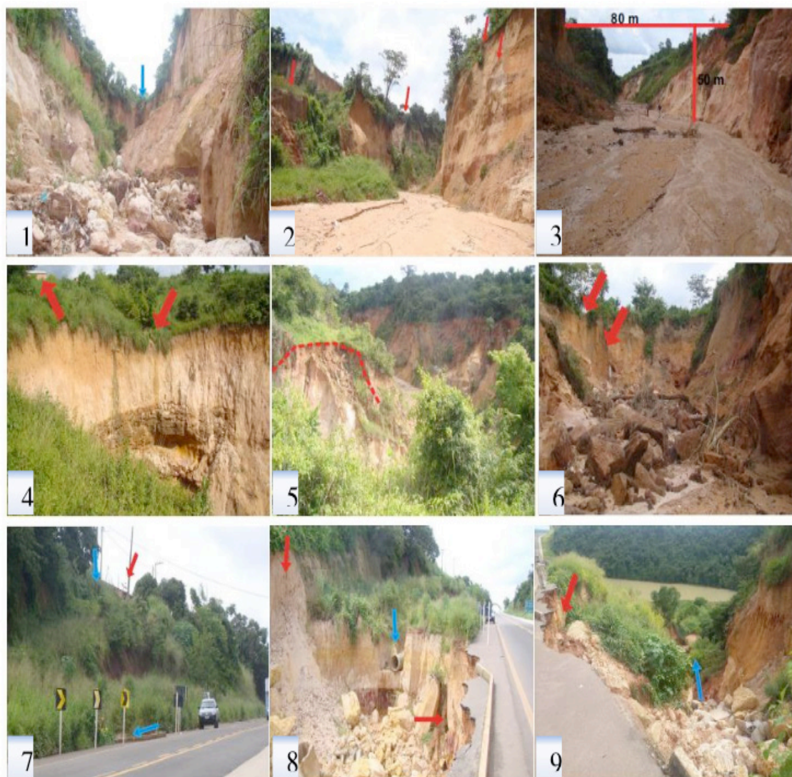
Figura 2: Voçorocas urbanas em Bom Jesus das Selvas_MA – centro (fotografias 1, 2 e 3); região SW da cidade (fotografia 4, 5 e 6); BR 222/entrada da cidade (fotografias 7, 8 e 9). Setas: em vermelho – terminações de drenagens e tubulações; em azul – direção das linhas de água. Linha tracejada: superfície de deslizamento.
