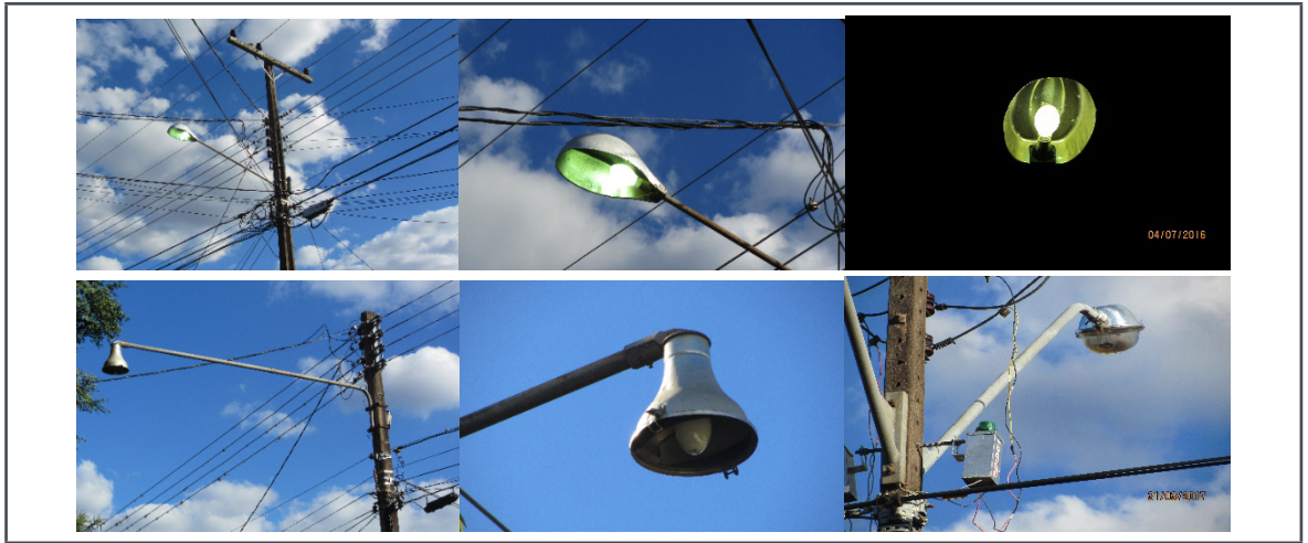
Figura 2 – Luminárias obsoletas (sem óptica definida) com lâmpada vapor de mercúrio (Fonte: Autor)
