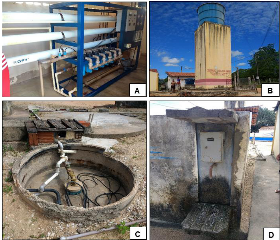
FIGURA 4 - Imagens de equipamentos referentes às etapas do processo de dessalinização na Comunidade Urua I. A) Dessalinizador por osmose reversa; B) Chafariz com reservatório de água bruta; C) Ponto de localização do poço; C) Ponto de localização da ficha de captação de água doce.
