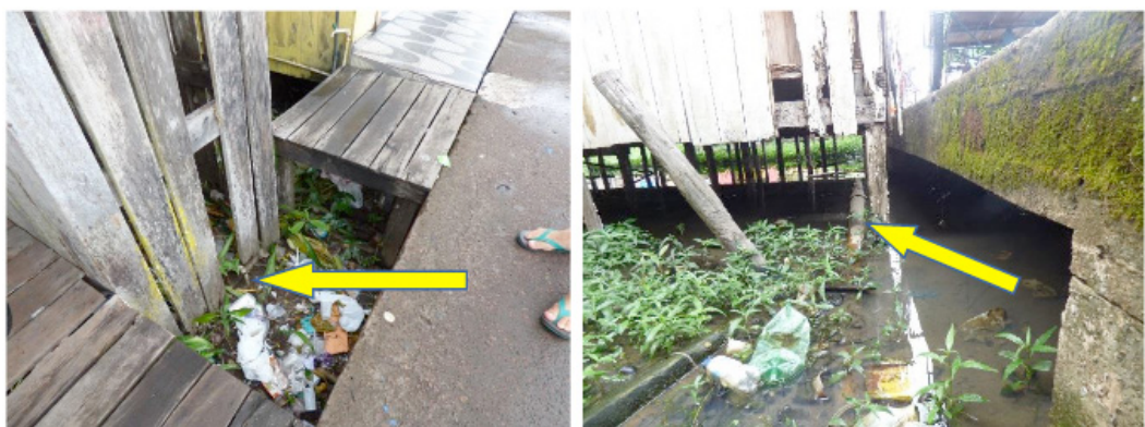
Figura 11. Alguns locais onde se encontram a rede de distribuição de água do município de Afuá – PA.
