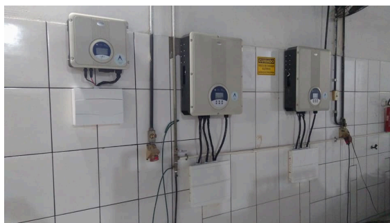
Figura 4: Inversores que compõem a parte interna do sistema fotovoltaico do estabelecimento comercial, São Gabriel – RS, 2018. Fonte: Autores, 2018.
