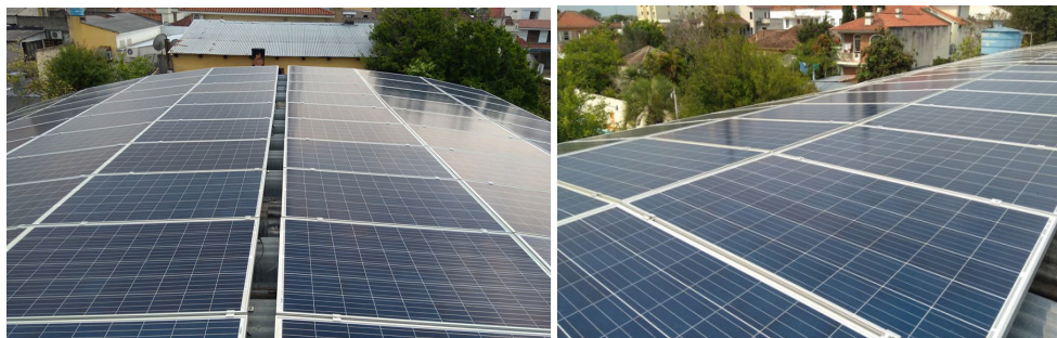
Figura 3: Painéis fotovoltaicos instalados no telhado do estabelecimento, São Gabriel – RS. Fonte: acervo ABIB, 2017.
