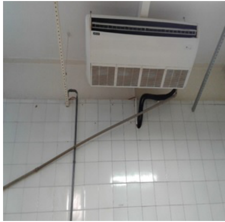
Figura 2. Coleta do aparelho de ar condicionado do laboratório.
