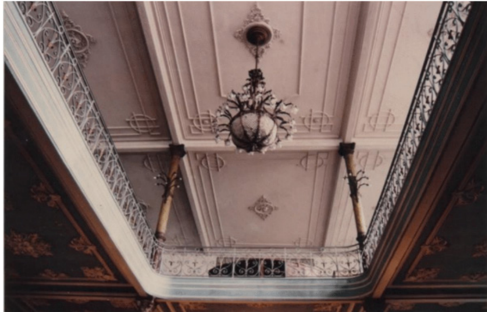
Foto 4: Estuques em gesso no forro.
