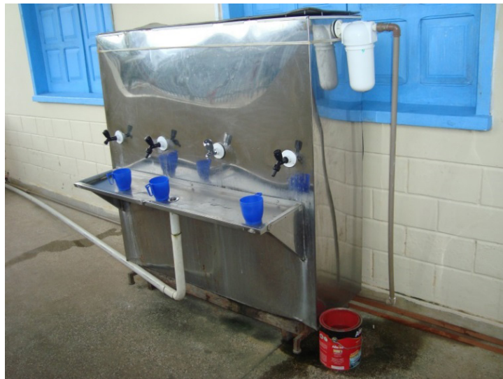
Figura 5. Bebedouro instalado na escola municipal da comunidade.
