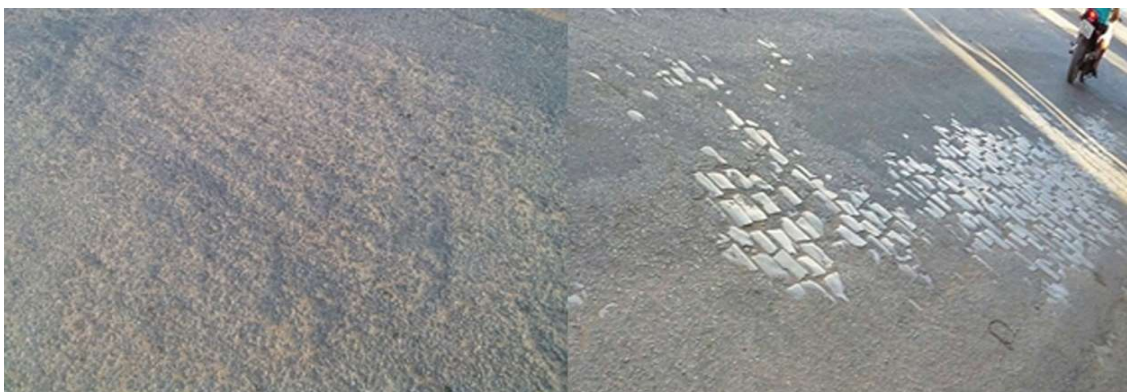
Figura 4. Desgaste do pavimento
