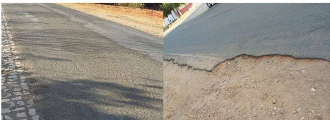
Figura2. Ausência das obras complementares
